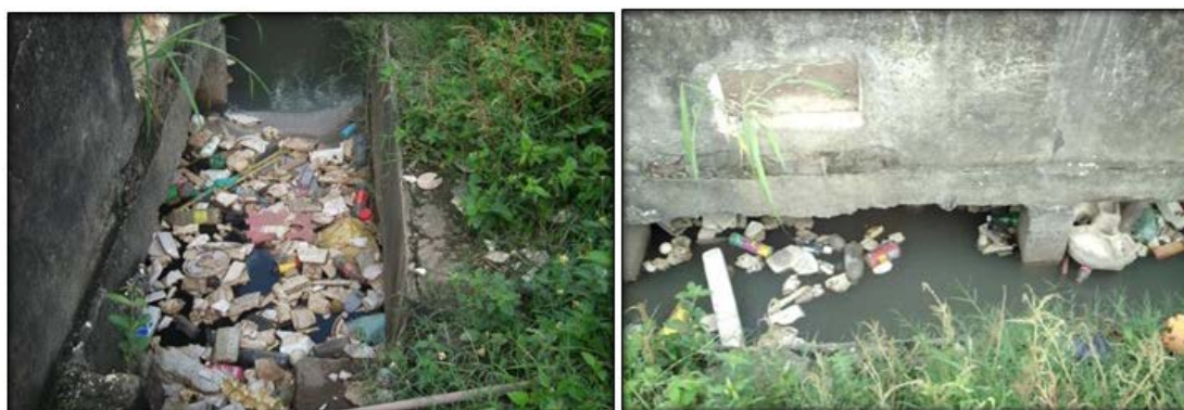
Figura 13: Rede de drenagem entupida por resíduos sólidos
