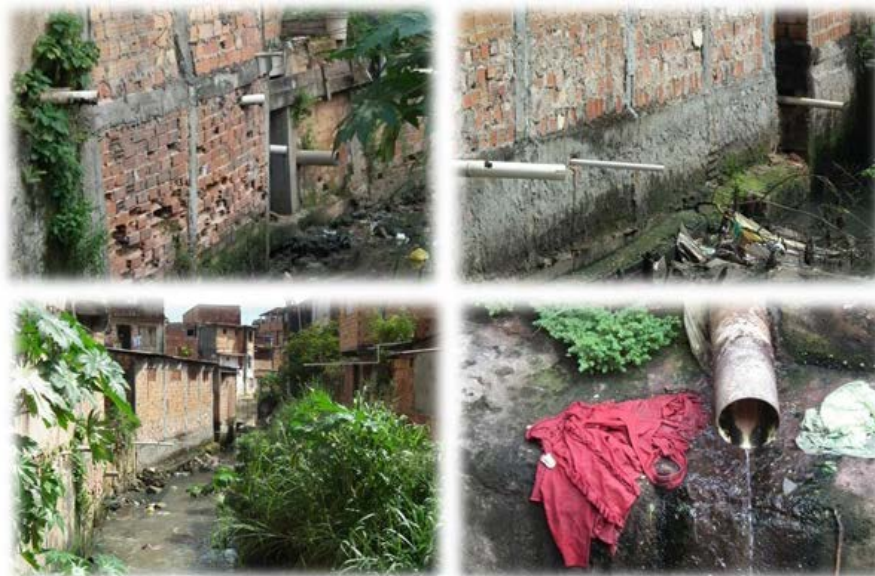
Figura 5: Ligações de esgoto das residências do bairro
